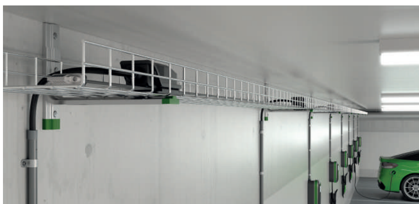
Dans la gaine grillagée ou le chemin de câble
